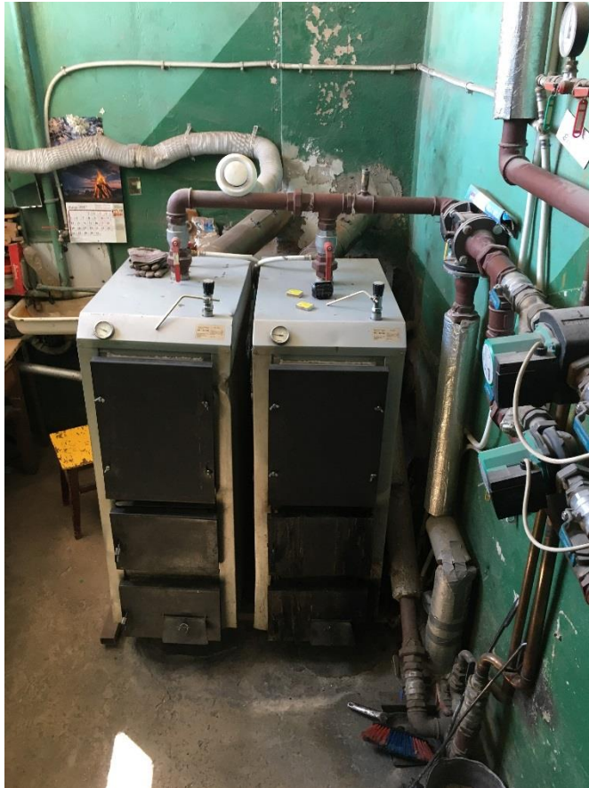
Att. Nr.17 Apkures katli
