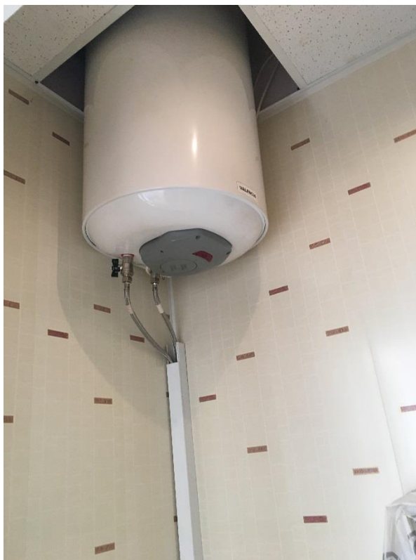
Att. Nr.10 Boileris karstajam ūdenim
