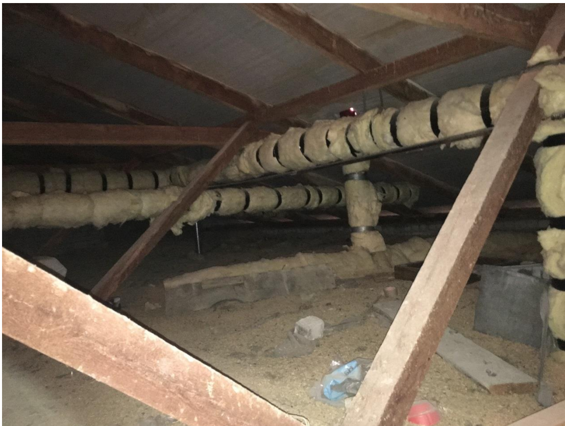
Att. Nr.12 Nosiltināti 1.stāva pārsegums un ventilācijas gaisa vadi
