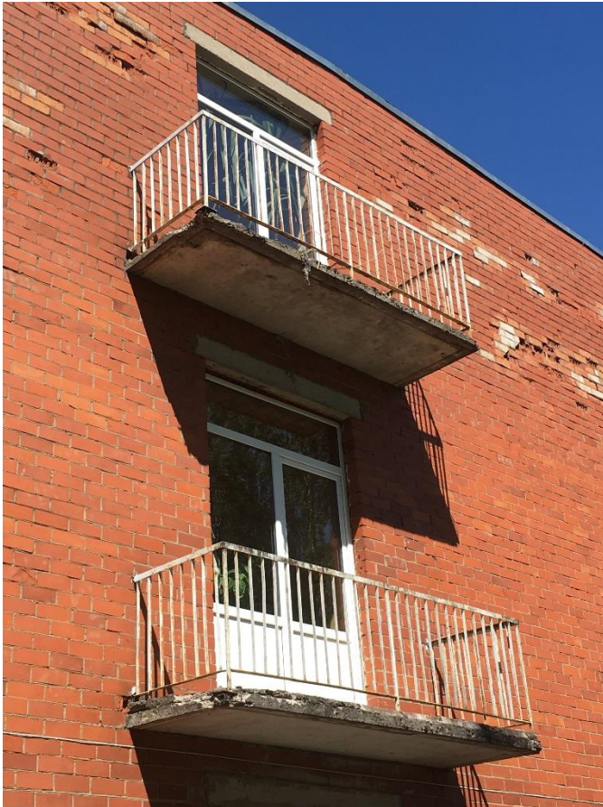
Att. Nr.3 Fasāde un balkoni sliktā tehniskā stāvoklī.
