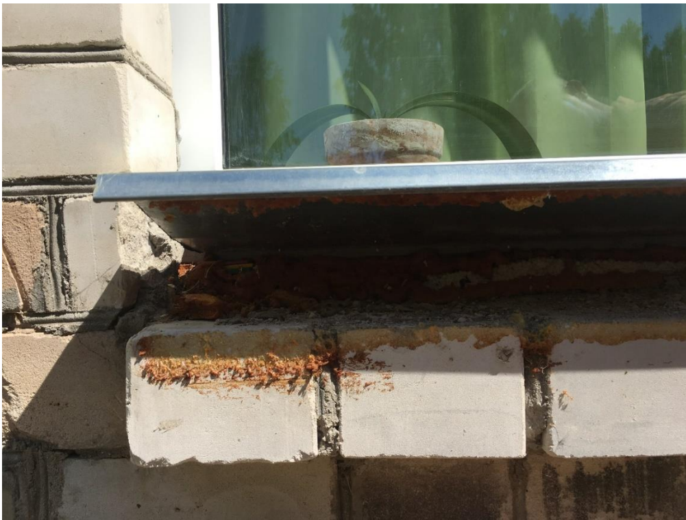
Att. Nr.4 Nepietiekša un nekvalitatīva siltumizolācija zem logu palodzēm
