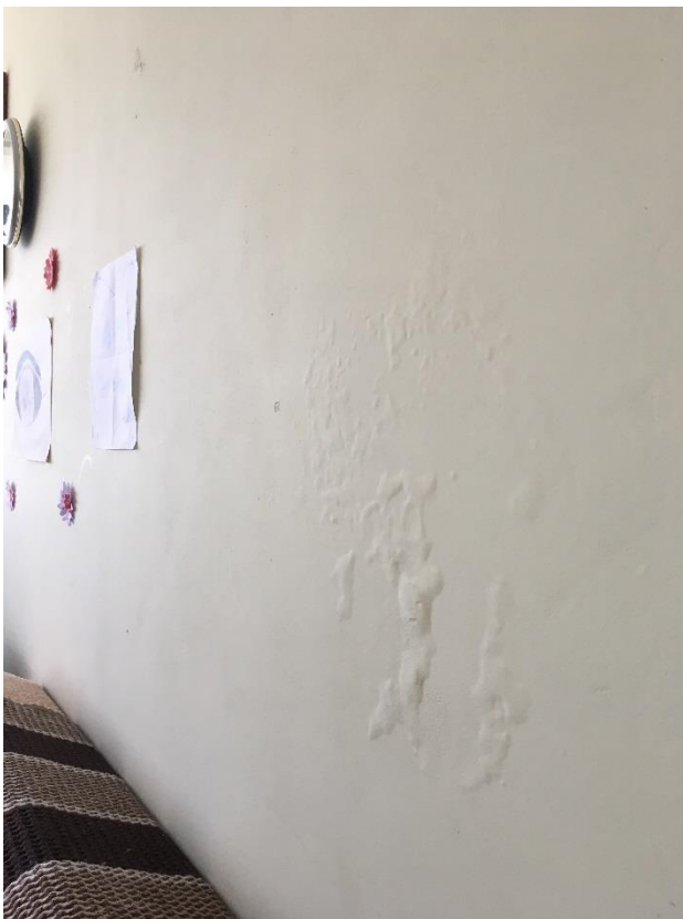
Att. Nr.10 Saburbusi gala sienas apdare paaugstināta iekšējā mitruma dēļ
