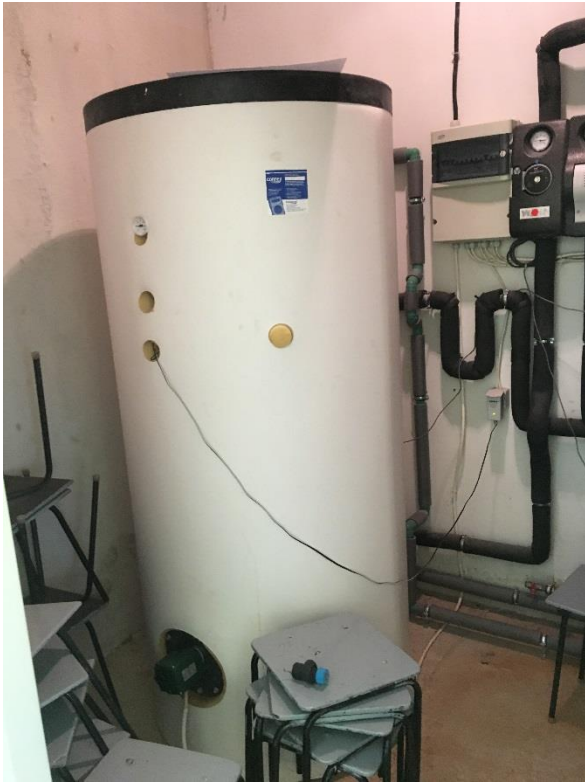
Att. Nr.21 Siltā ūdens akumulācijas tvertne, kas šobrīd nedarbojas
