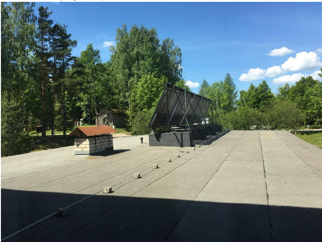
Att. Nr.20 Jumta segums uz ēdināšanas bloka. Saules kolektora sistēma, kas nefunkcionē
