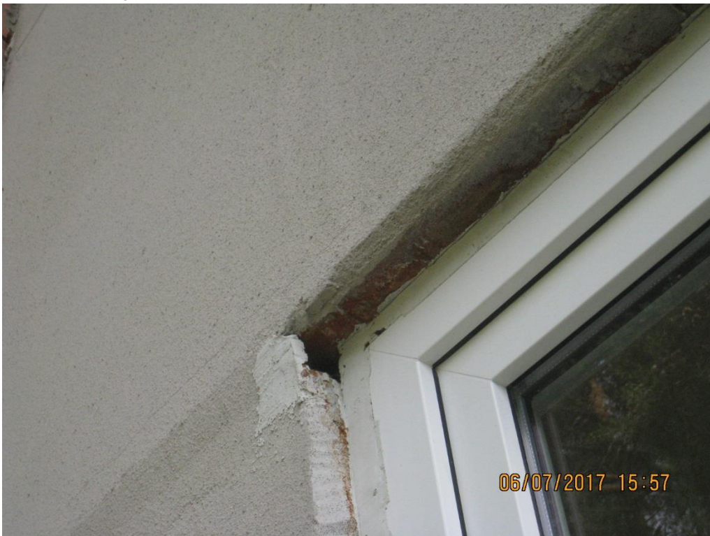
Att. Nr.4 Logs nav kvalitatīvi iebūvēts. Sprauga loga savienojuma stūrī
