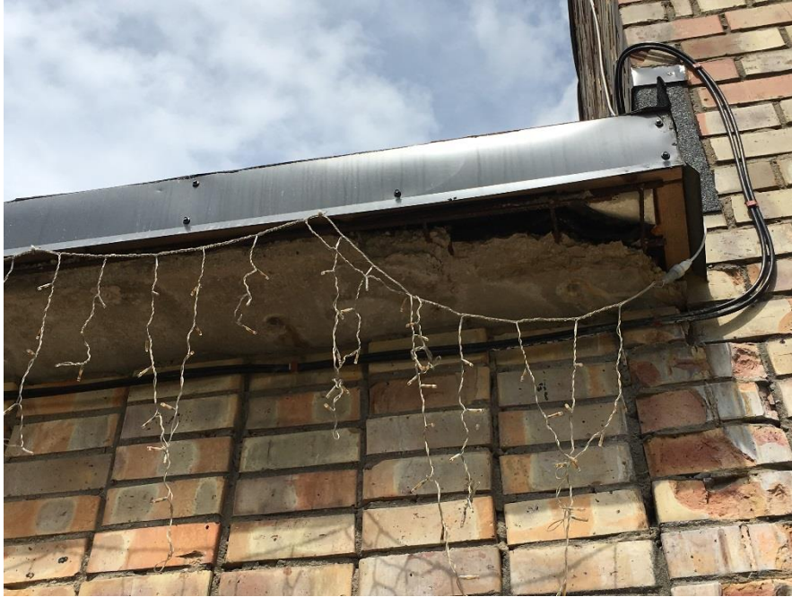
3. Ēkas jumta dzelzsbetona pārkare izdrupusi mitruma un aukstuma rezultātā.
