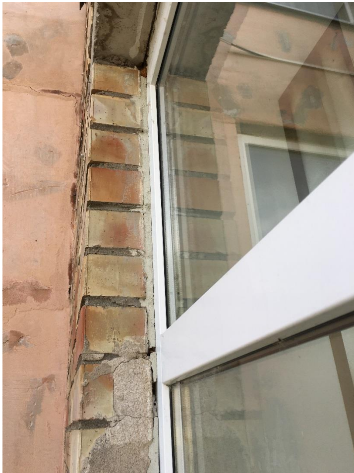
4. Spraugas starp plastikāta logu un ķieģeļu mūri.
