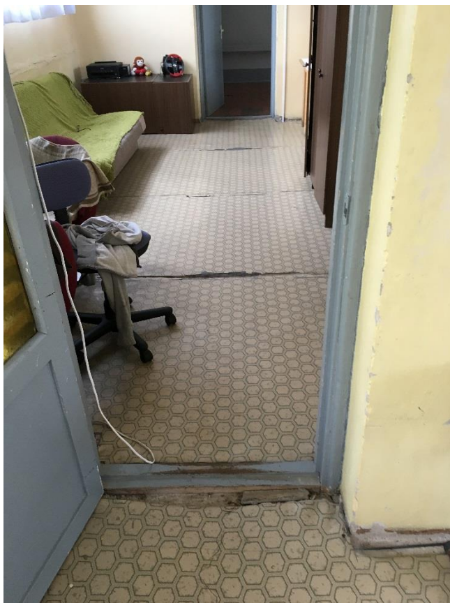
15. 2.stāva grīda sliktā tehniskā stāvoklī
