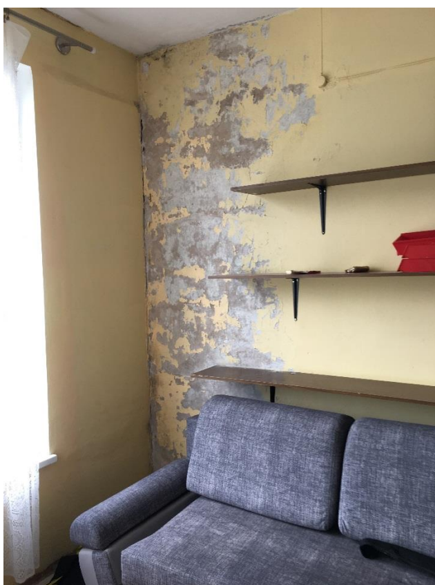
16. Nolupusi sienas apdare kondensāta dēļ
