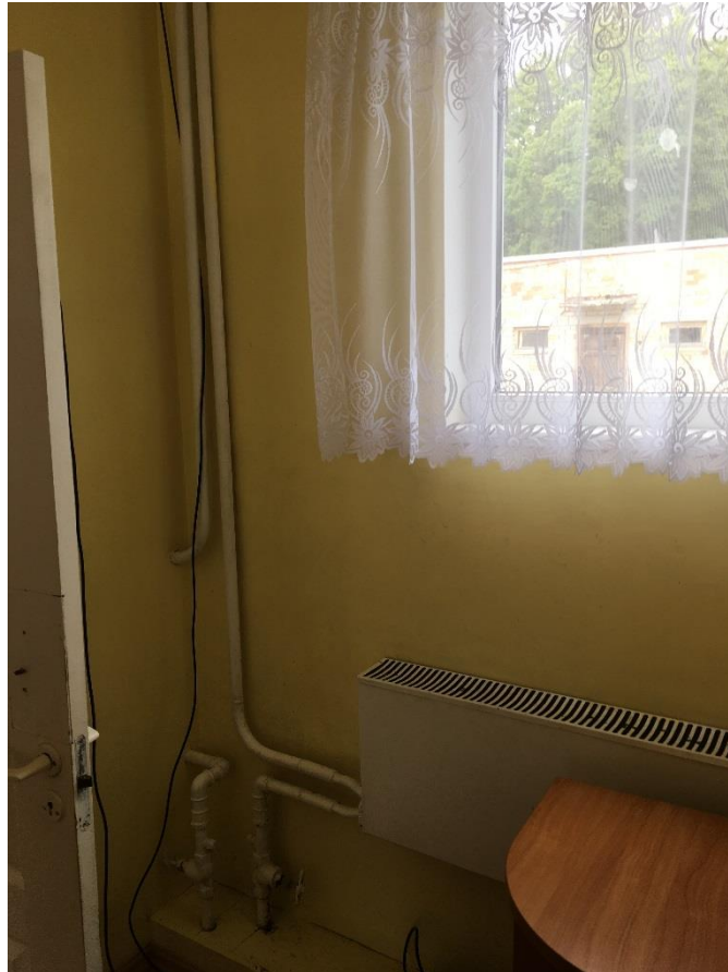
21. Apkures sistēmas caurules un radiators - konvektors
