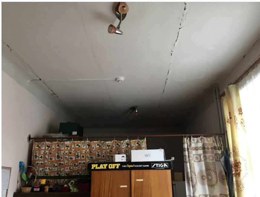
4. Aprūpētājas telpas griesti. Saplaisājušu paneļu savienojumu vietās.
