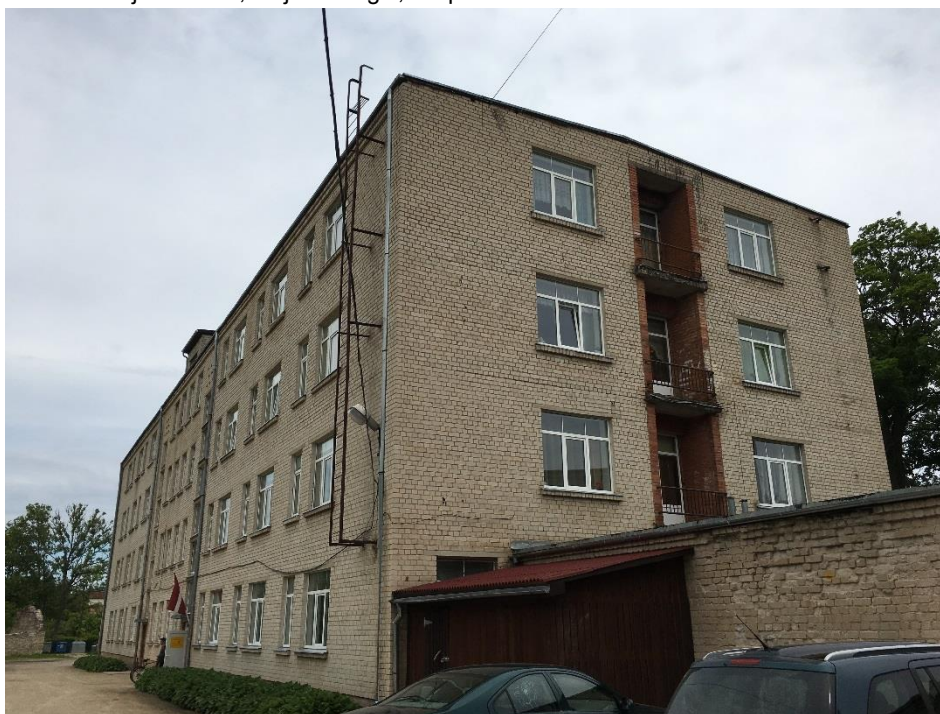
2. Ēkas fasāde. Iekšējie balkonu sienas cieš no mitruma ietekmes.
