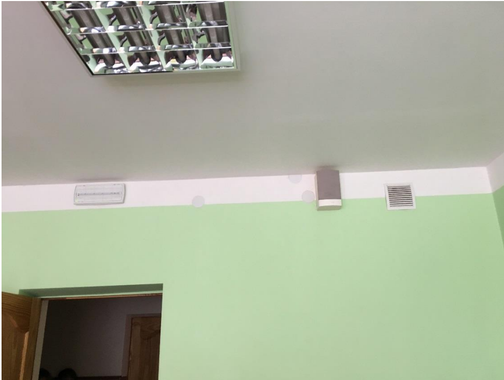
9. Ventilācijas restītes, apziņošanas skaļruņi, gaismekļi
