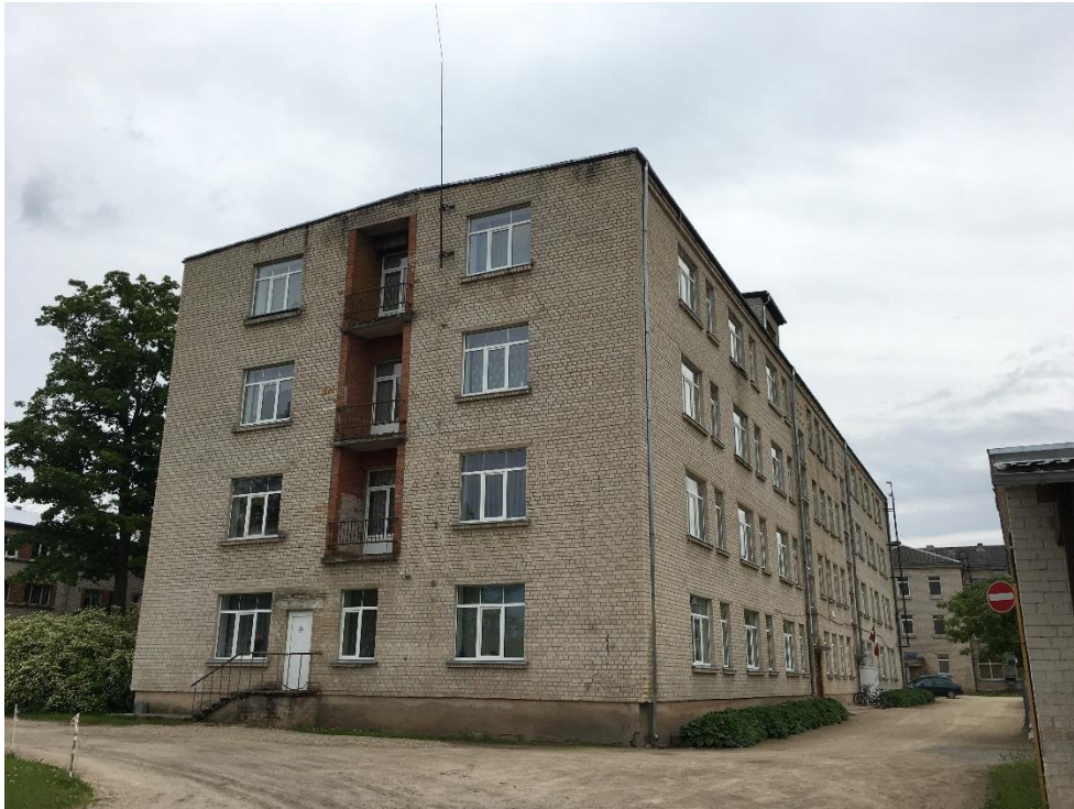
1. Ēkas fasāde. Iekšējie balkoni, ieejas mezgls, virspamats cieš no mitruma ietekmes.
