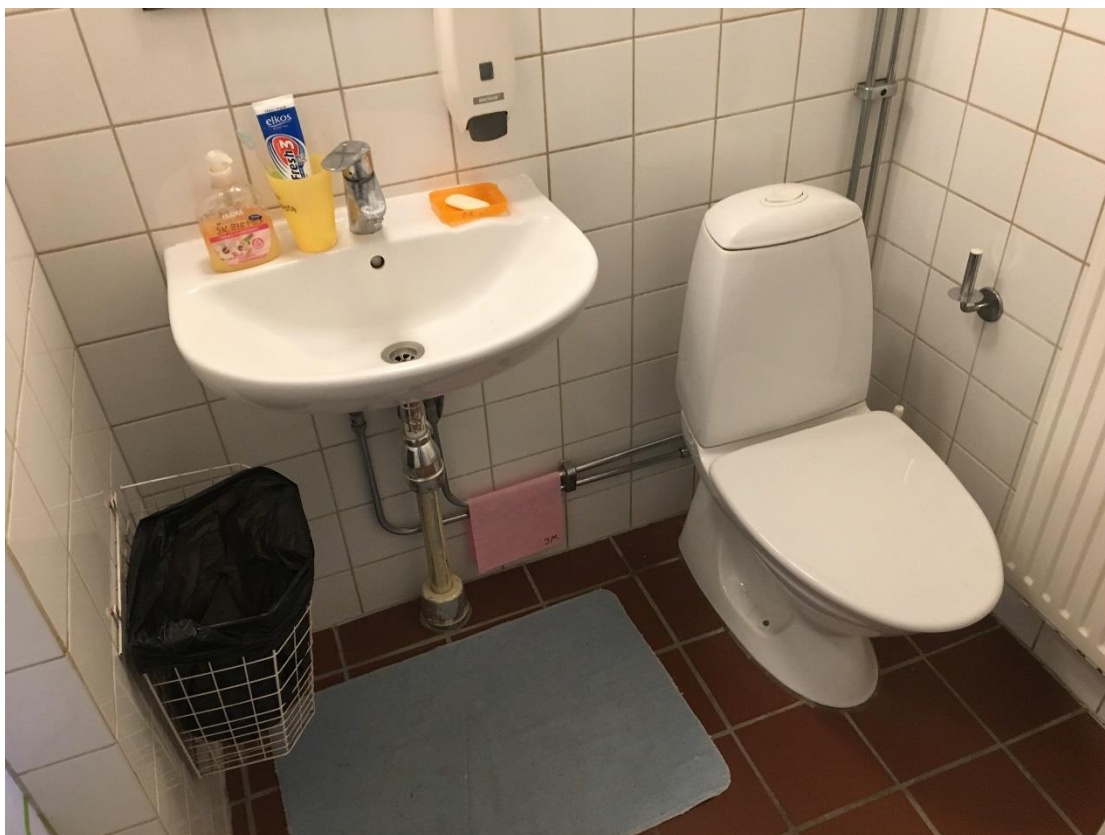
Att. Nr.8 Sanitārais mezgls
