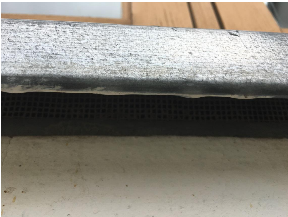
Att. Nr.18 Ārpusē gaisa kanāla restīte zem loga
