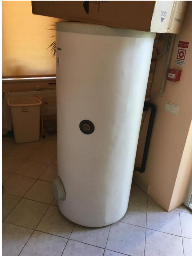
Att. Nr.19 Karstā ūdens rezervuārs - boileris
