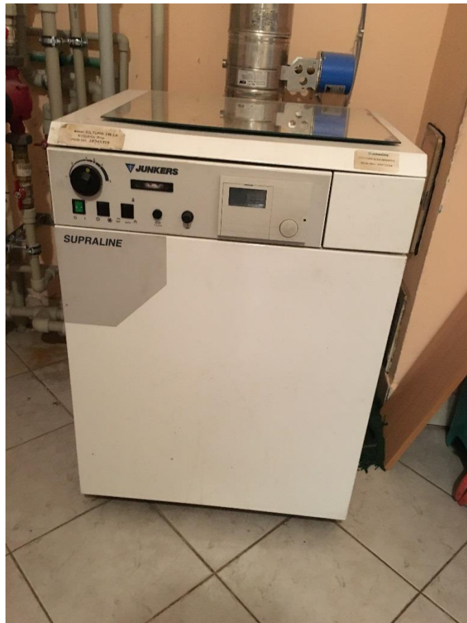
Att. Nr.18 Ķīmenes mājas apkures katls
