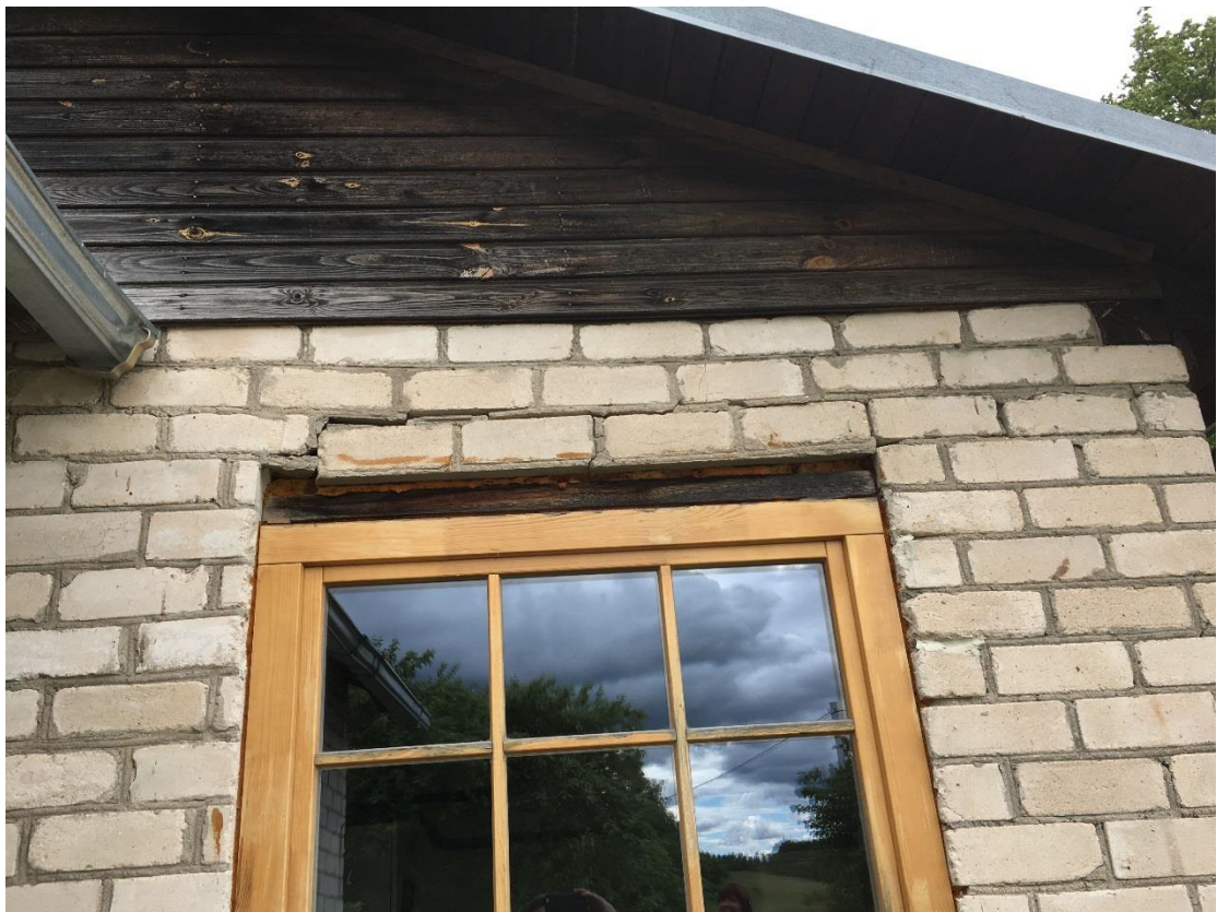
Att. Nr.26 Atdalījušies ķieģeļi virs loga pārsedes
