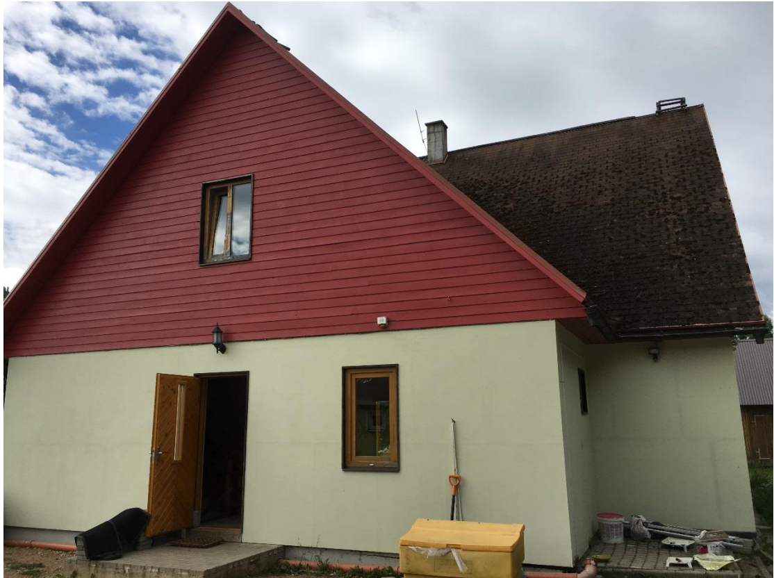
Att. Nr.13 Bērnu dzīvojamās mājas "Kļavas" fasāde. Nav ūdens noteku.
