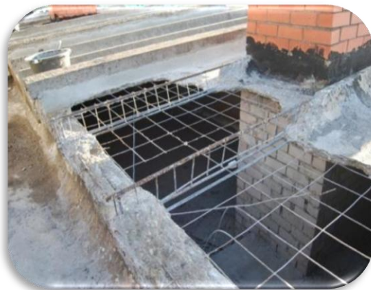
Bojāta jumta konstrukcija
